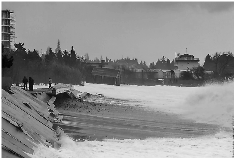
Рис. 1. Просадка и разлом элементов берегозащитных конструкций.
